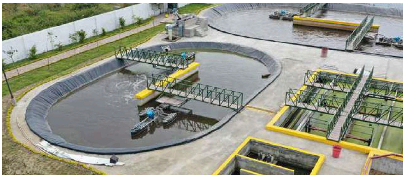
Figura 64. Planta de Tratamiento de Aguas Residuales
