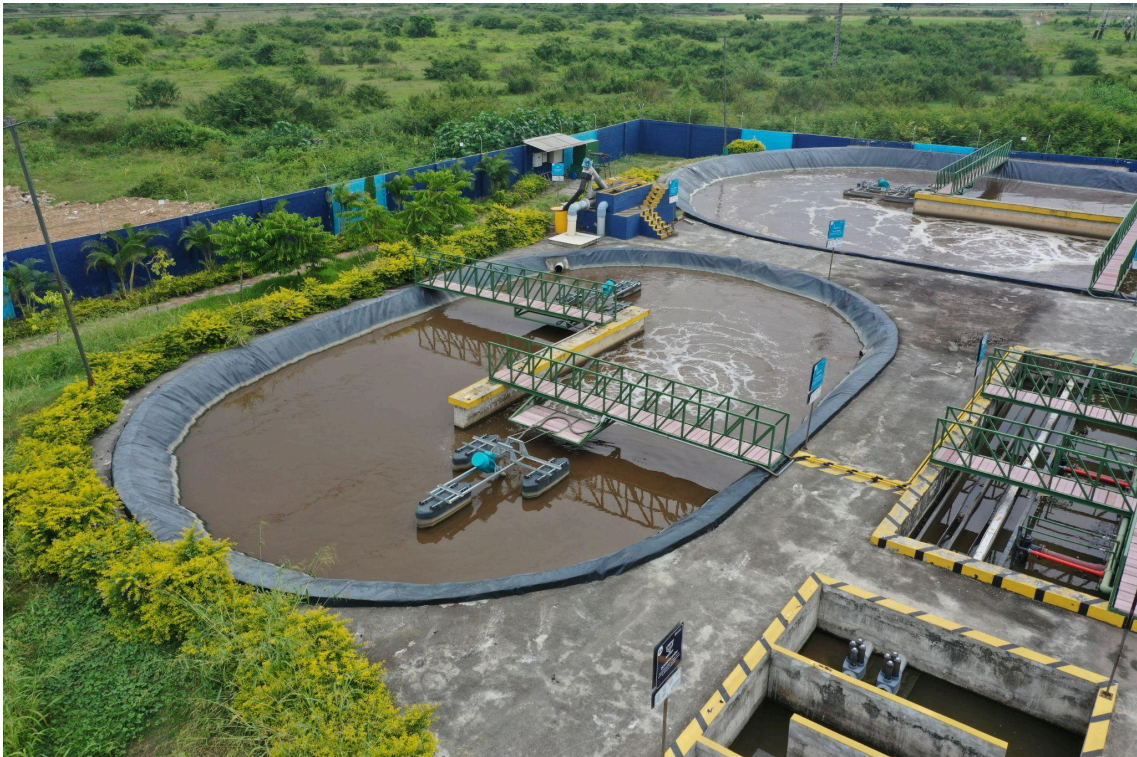
Fotografía 34. Vista panorámica de la Planta de tratamiento de aguas residuales
