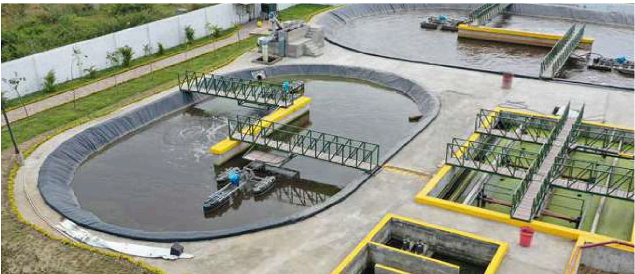
Figura 64. Planta de Tratamiento de Aguas Residuales
