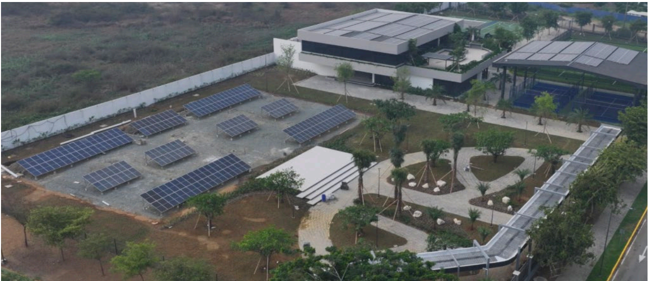
Figura 63. Parque Solar ECOTEC
